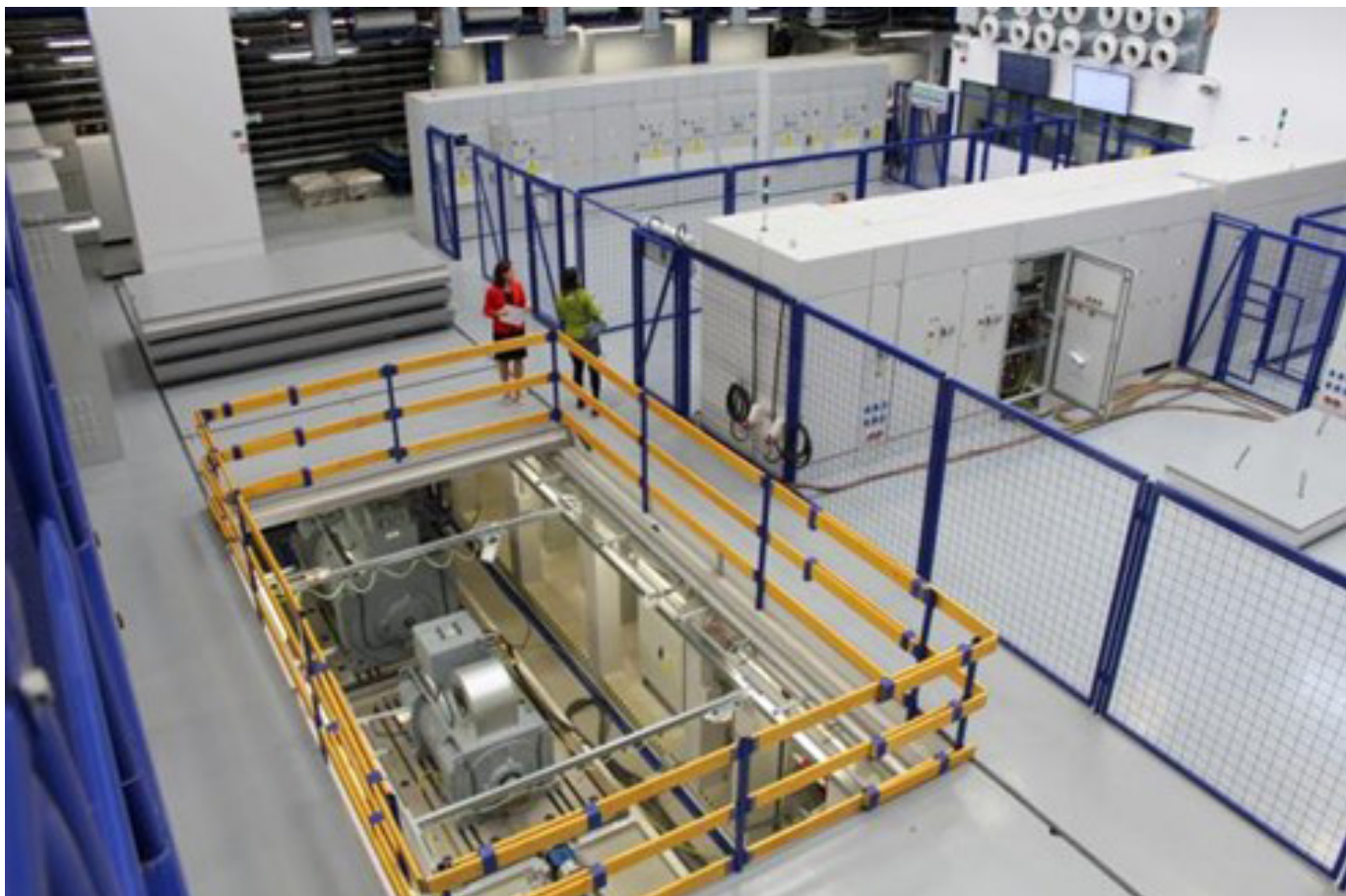
Pohled do suterénu na instalované VN motory
